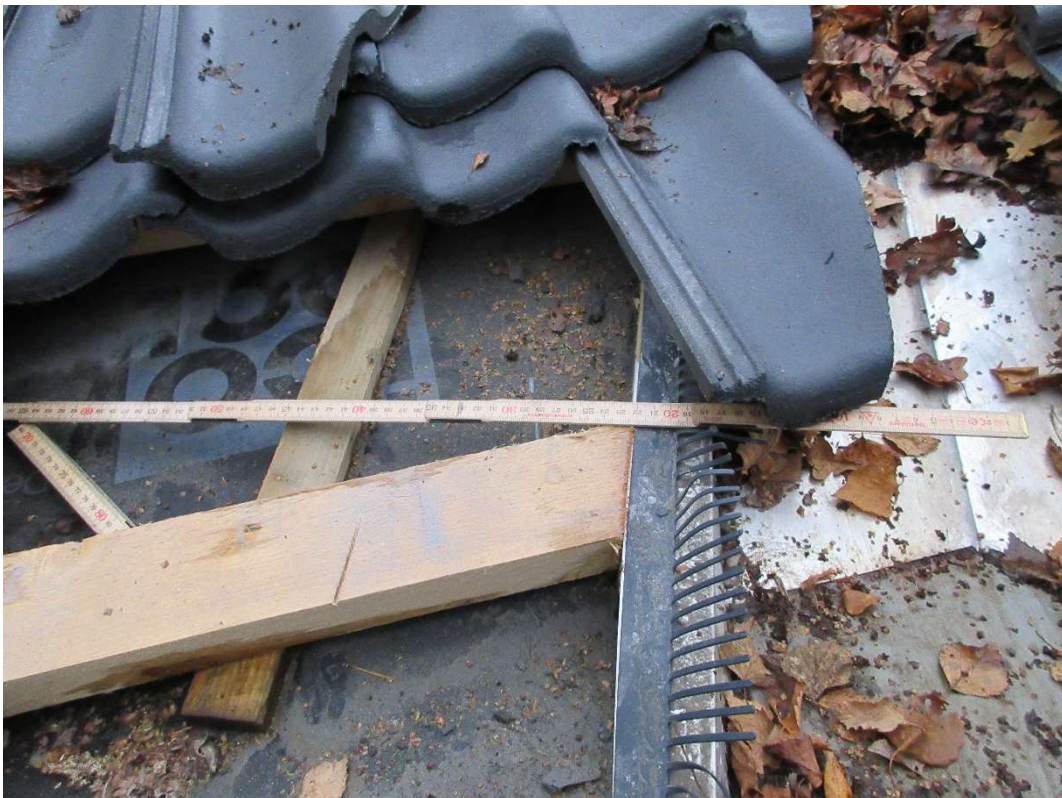
Foto 1: Opfugtede afstandslister, undertag og lægte ved skotrendebunden
